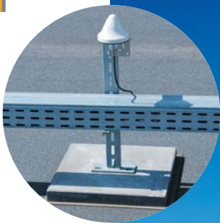
Instalacja antenowa systemu łączności
